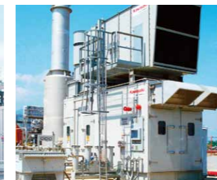
GPB30D (M1T-13) パイプラインブースターステーション向け
