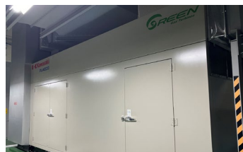
非常用発電装置
