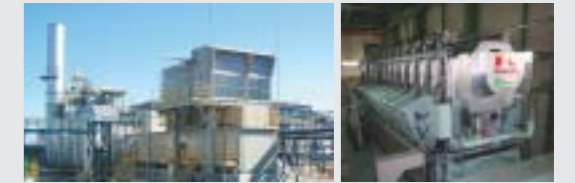
MC塩浜エネルギーサービス株式会社向け15.9MWガスタービンコージェネレーション発電設備 カワサキグリーンガスエンジン
