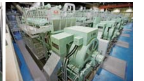
日本テクノ(株)袖ヶ浦グリーンパワー向けガスエンジン発電設備
